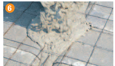
6 COLADO. Se tapan los huecos de las bovedillas extremas, se mojan perfectamente las viguetas y bovedillas y se procede al colado de la capa de compresión.
